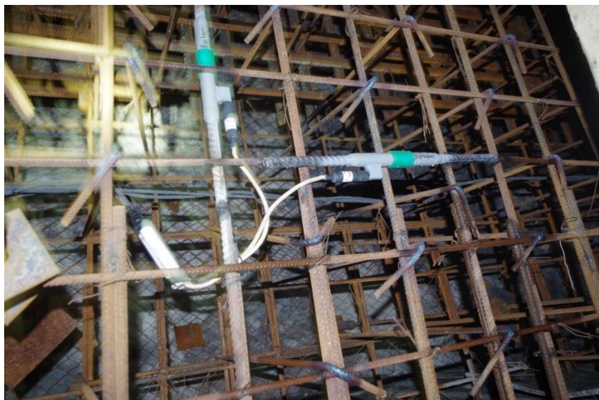
Рис. 3 – Расположение датчиков ПСАС в арматуре
