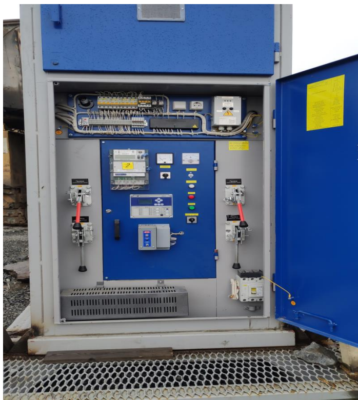
Рис. 2 – Пункт подключения приемников к линии электропередачи с комплектом релейной защиты
