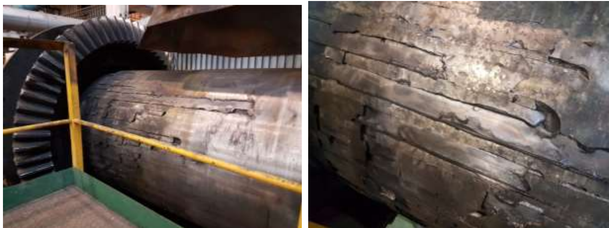
Рисунок 6 – Разрушенный слой эксцентрика
