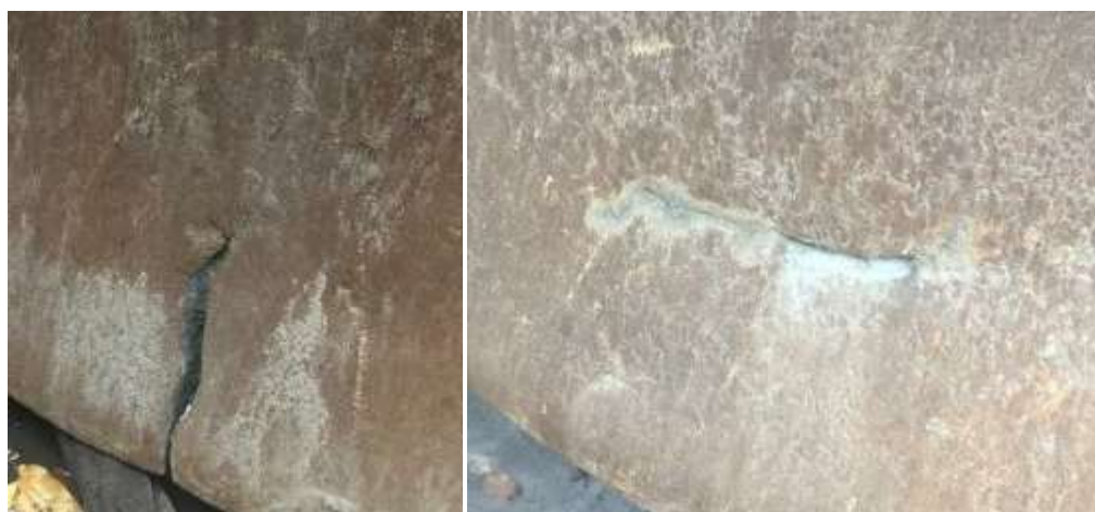
Рисунок 2 – Трещины в броне конуса
