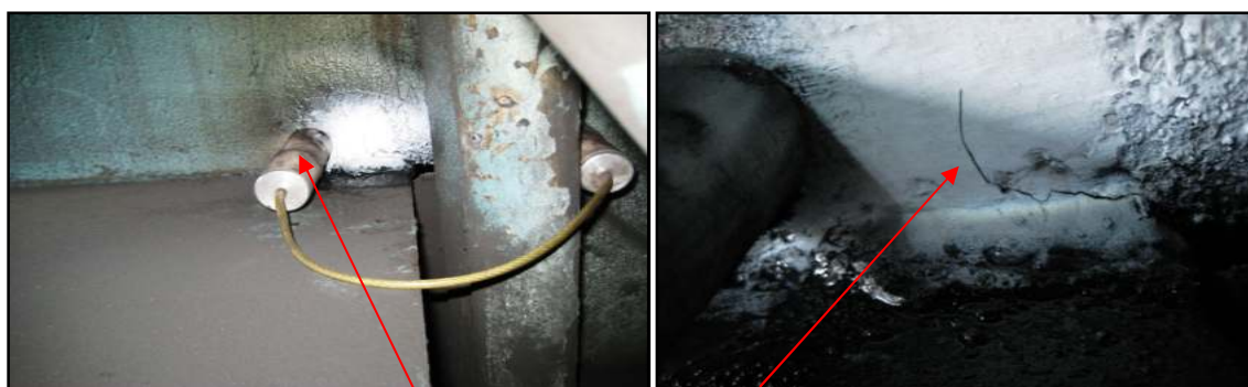
Рис. 3 – Характерные усталостные трещины кронштейна крепления редуктора замыкания грейфера (сторона ВА).
